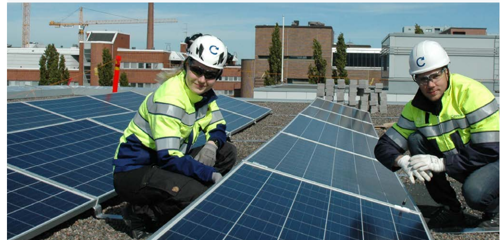
Projektipäällikkö Rea Tiehaara ja huoltopäällikkö Jussi Wacklin Caverionista tarkastavat kesällä 2016 asennettuja aurinkopaneeleja.
